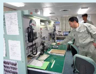
▲船内には無線も設置されています
