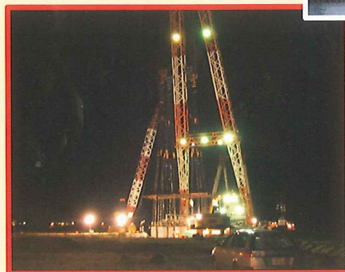
▲外港地区は空港との距離が近いのでケーソン据付けは夜間作業になります。
