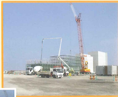
▲コンクリートを流し込んで、徐々にケーソンが出来上がっていきます。写真奥に見えるのが、完成したケーソン。
