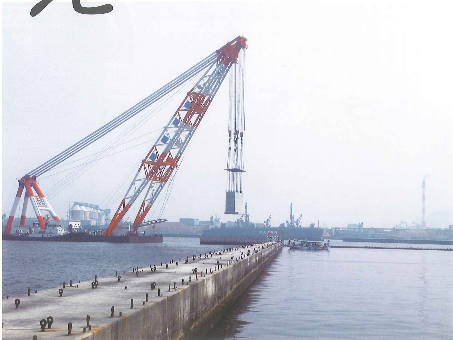
三島川之江港 金子地区 護岸のケーソン(約600t)の据付が始まる場所
