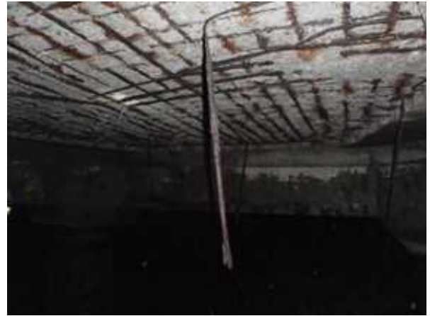
床版コンクリート(裏面)の劣化状況
