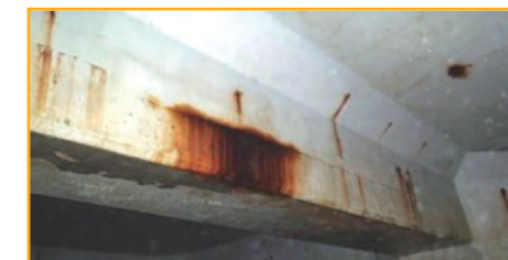
老朽化状況(梁側面)
