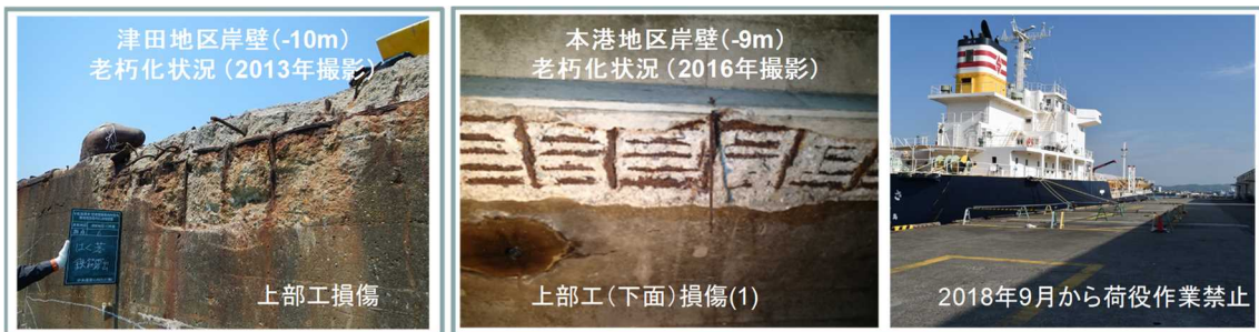
図 3.5 港湾施設の老朽化状況
