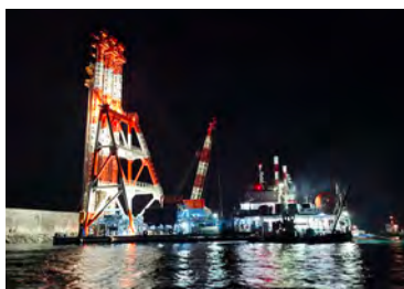
地盤改良工 (サンドコンパクション工)実施状況 (令和8年2月撮影)
