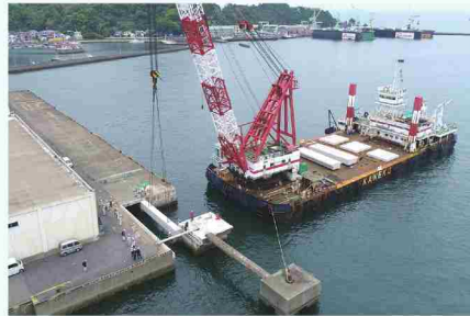
岸壁のリニューアル工事の様子 (新たに製作した部材の据付作業)
