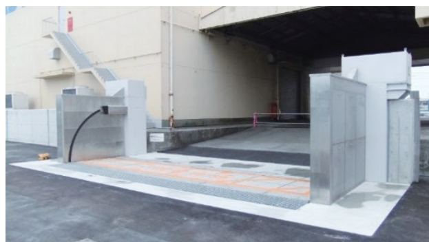
撫養港海岸に設置されたフラップゲート式陸閘
