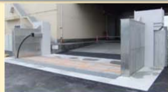
フラップゲート式陸閥(自動化陸閥)
