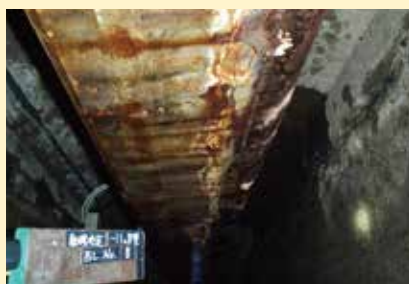
(b) 梁コンクリート
