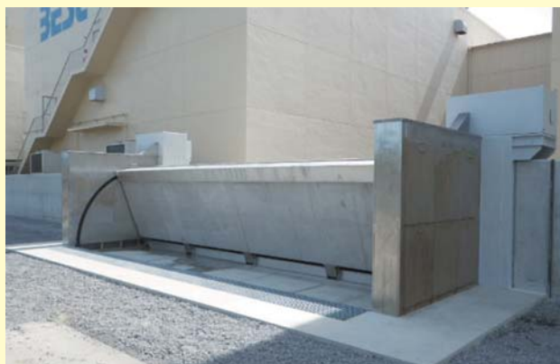
↑ フラップゲート式陸閘(閉鎖時)
