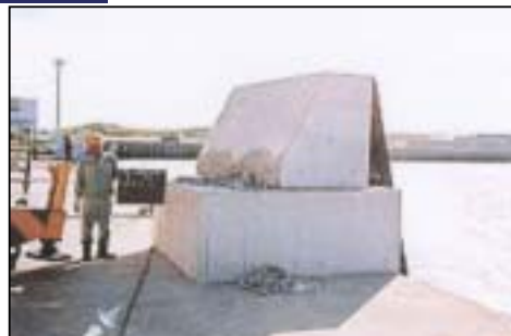
岸壁の損傷:高知県資料
