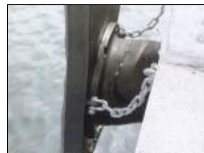
防舷材の損傷:高知県資料
