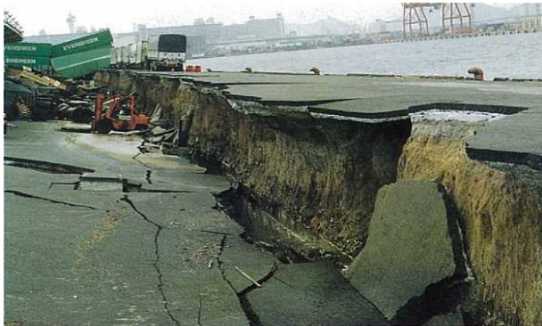
兵庫県南部地震(神戸港)
