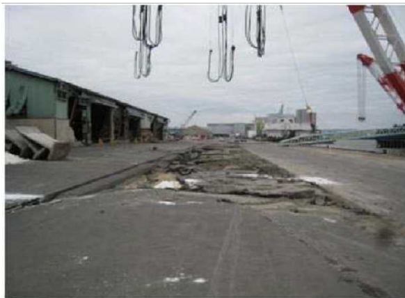
東北地方太平洋沖地震(石巻港)
