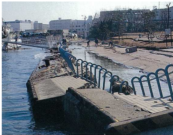
兵庫県南部地震(神戸港)
