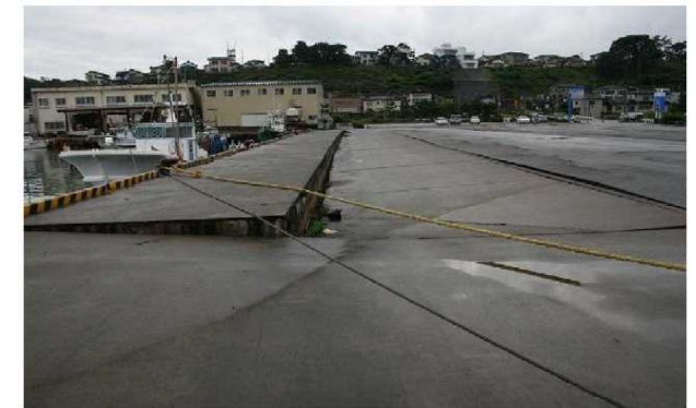
新潟県中越沖地震(柏崎港)
