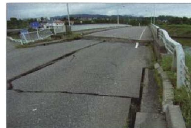
新潟県中越沖地震(柏崎港)
