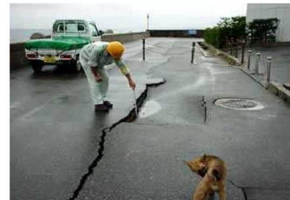
鳥取県西部地震(外周道路)
