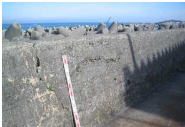
堤防のひび割れ (富山県 滑川漁港海岸)
