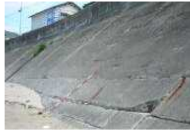
堤防のひび割れ (長崎県 脇岬西南海岸)
