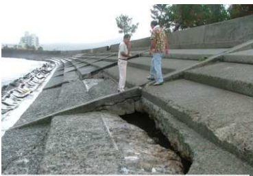
護岸の劣化・空洞化 (鹿児島県 東方海岸)
