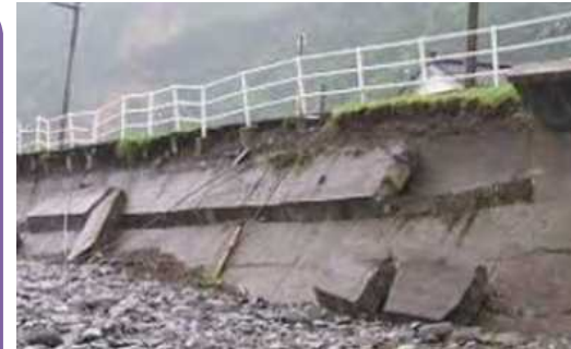
平成19年新潟県中越沖地震における護岸の被災(上輪海岸)
