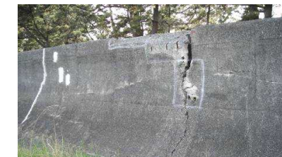
堤防のひび割れ・鉄筋の露出 (静岡県 清水海岸)
