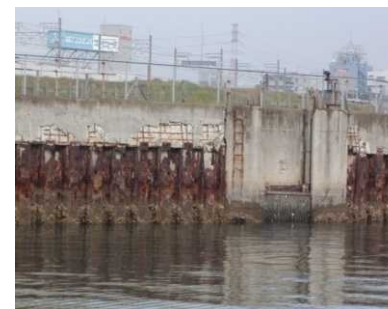
鋼矢板の腐食・コンクリートの劣化
