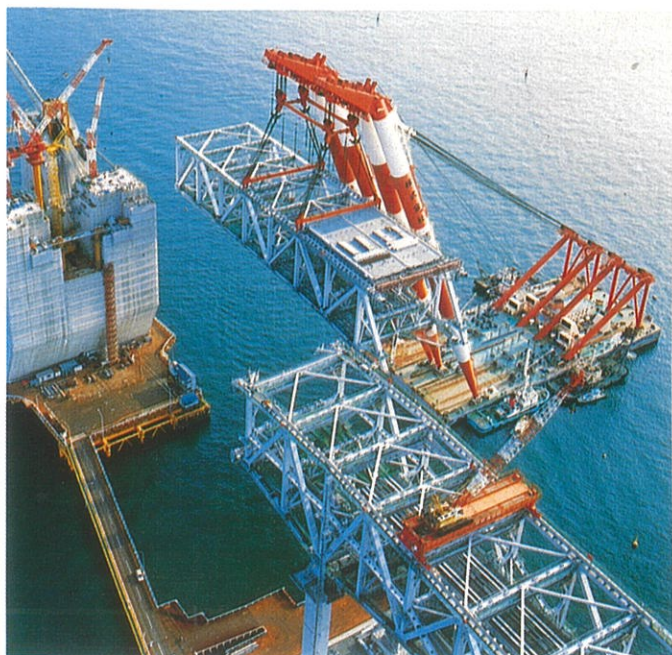
本州四国連絡橋 児島一坂出ルート 番の州高架橋架設工事
