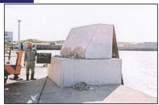
岸壁の損傷:高知県資料
