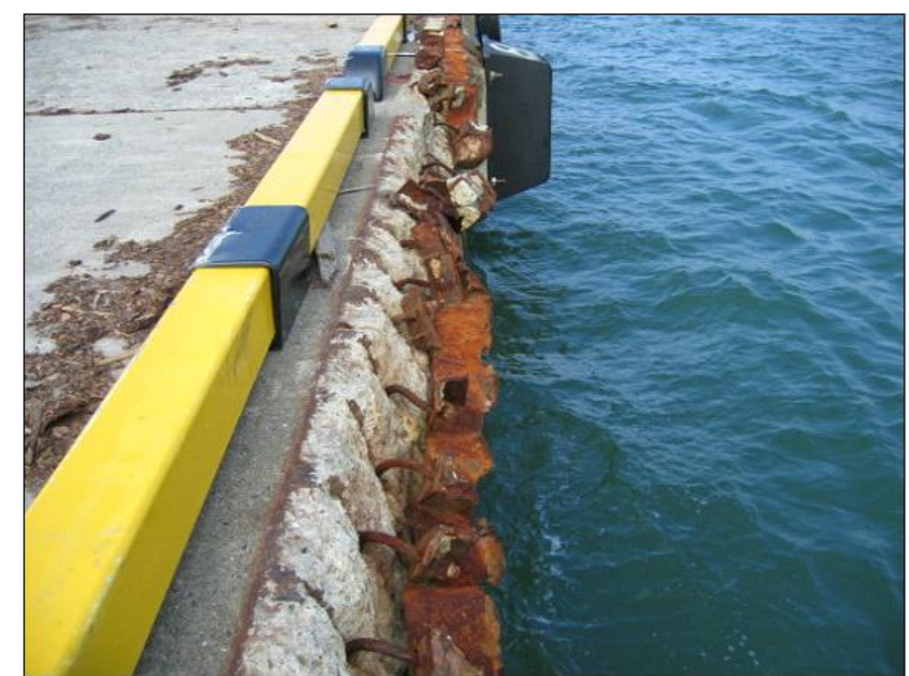
老朽化による車止め、縁金物の劣化・破損
