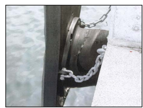
防舷材の損傷:高知県資料
