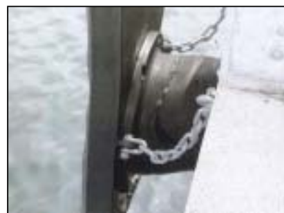
防舷材の損傷:高知県資料
