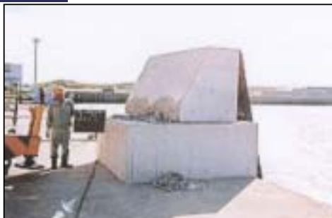
岸壁の損傷:高知県資料
