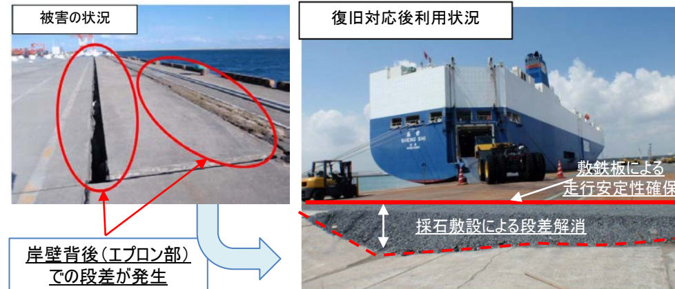
液状化被害の事後対応事例 (茨城港常陸那珂港区)
