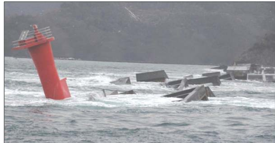
釜石港 湾口防波堤(北堤(990m)ほぼ全壊)
