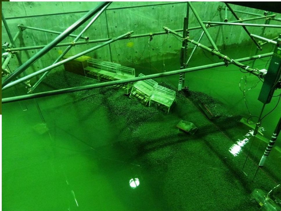
南堤頭部の洗掘による傾倒状況（隣の函も洗掘され傾倒）
