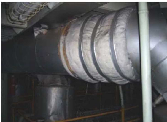
配管部分のアスベスト布団
