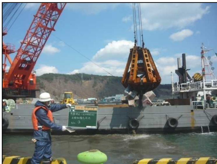
(起重機船によるブロックのバケット揚収) 写真一参 10(2) 東日本大震災での久慈港における異常点揚収状況
