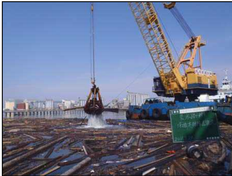
写真一参9(5) 東日本大震災での石巻港における浮遊(漂流)物揚収状況
