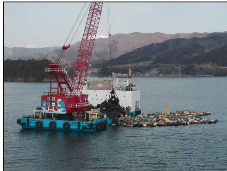
写真-参9(4) 東日本大震災での大船渡港における浮遊物揚収状況
