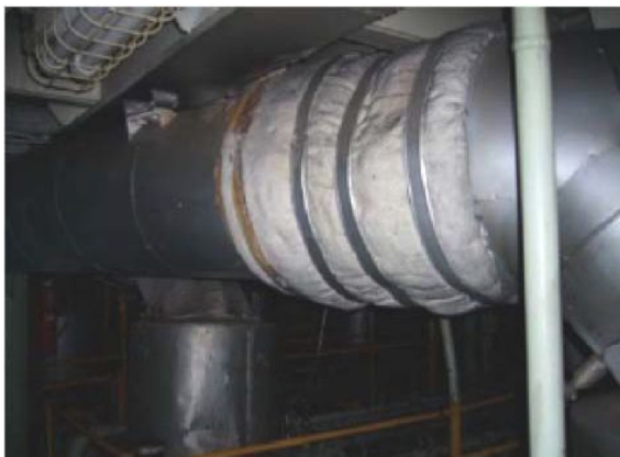
配管部分のアスベスト布団
