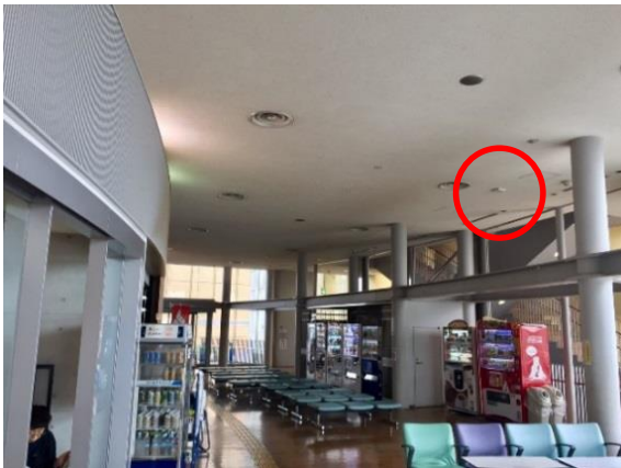
高松港旅客ターミナル2Fに常設されたWi-Fi設備
